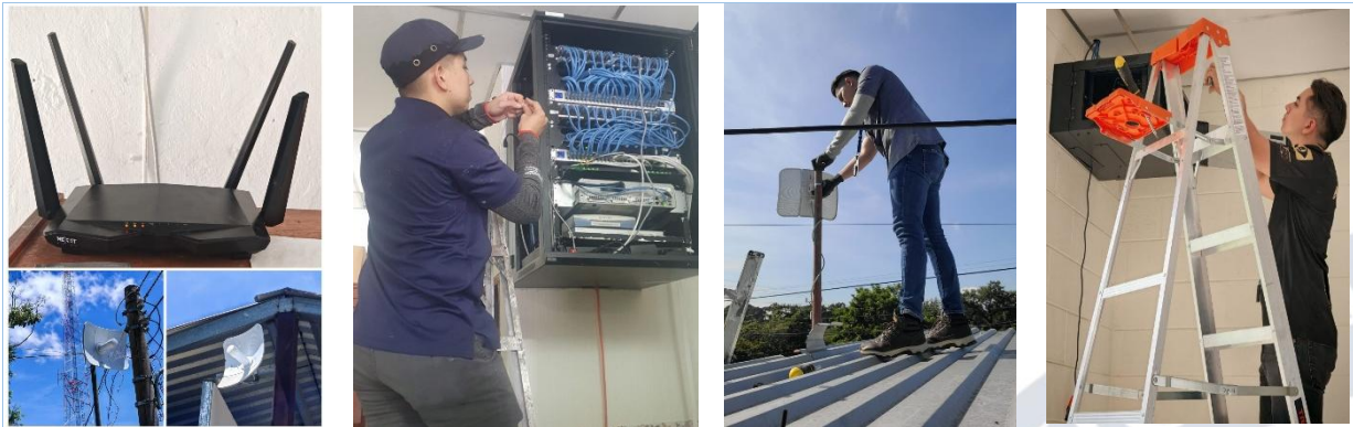
Cableado Policía Talnique, casa comunal Nuevo Lourdes y palacio municipal.
